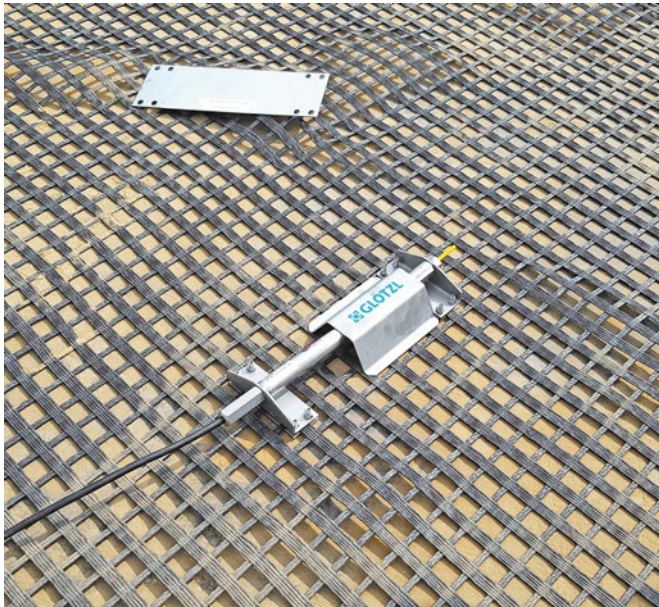
Bild 5 Geogitterdehnungsaufnehmer der Fa. Glötl während der Installation Geogrid strain transducer from Glötl during installation
